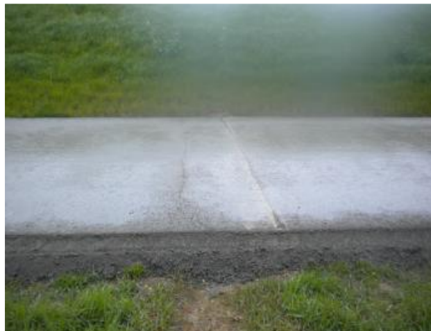
Рисунок 27 - Пример, образования трещины вблизи шва сжатия, который был нарезан слишком поздно
