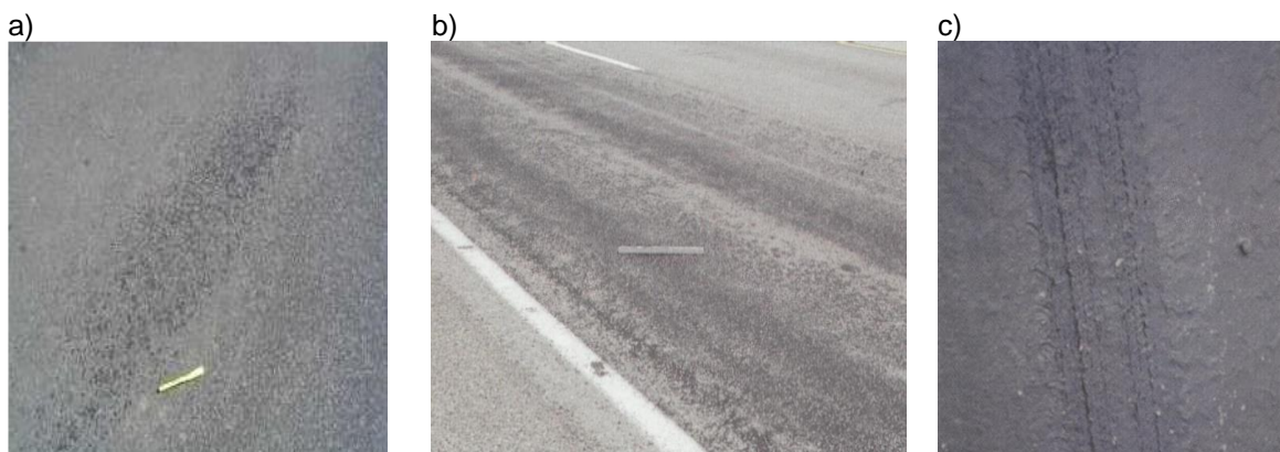
a) – nivel de severitate scăzut; b) – nivel de severitate mediu; c) – nivel de severitate ridicat
