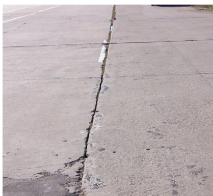
Рисунок 50 - Раскрытие продольных швов
