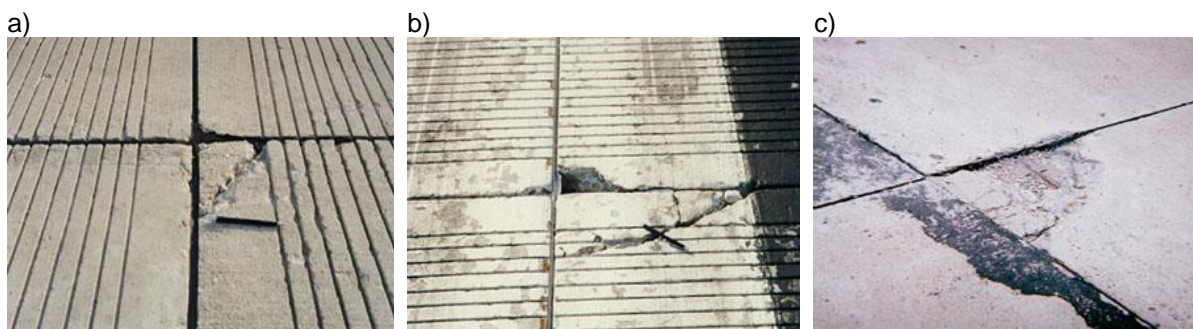
a) – nivel de severitate scăzut (S); b) – nivel de severitate mediu (M); c) – nivel de severitate ridicat (R)
