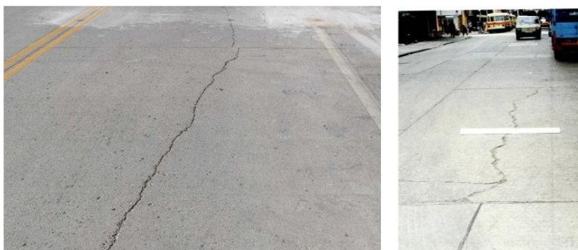
Figura 58 – Fisuri și crăpături longitudinale
