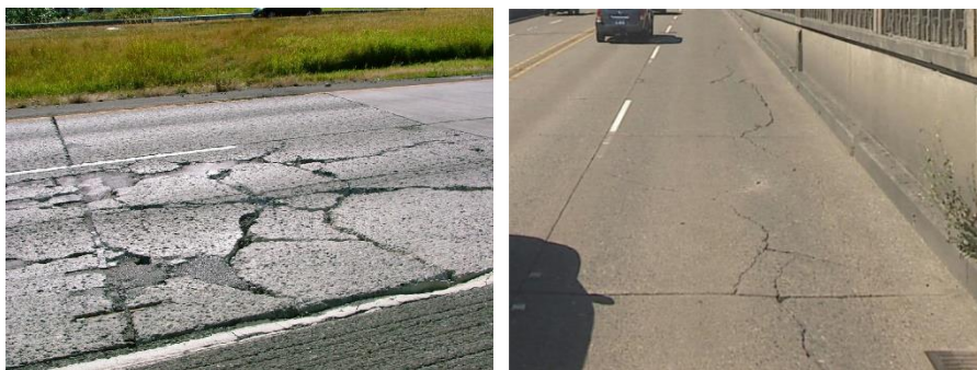
Figura 71 – Distrugerea totală a dalelor
