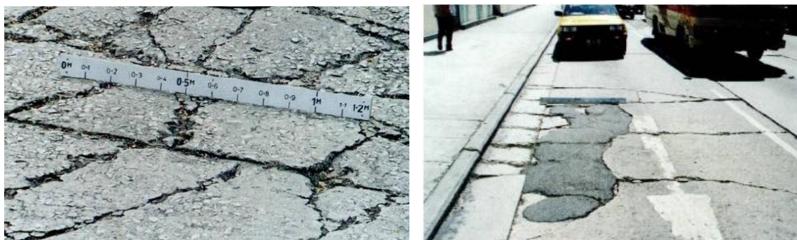
Figura 68 – Fisuri în plăci
