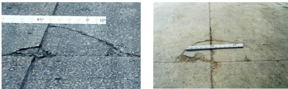
Figura 62 – Fisuri și crăpături de colț
