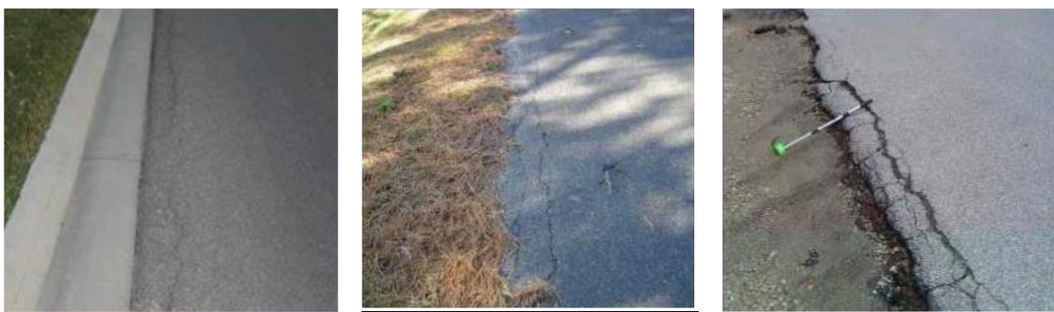
a) - nivel scăzut de severitate (S); b) - nivel mediu de severitate (M); c) - nivel ridicat de severitate (R)
