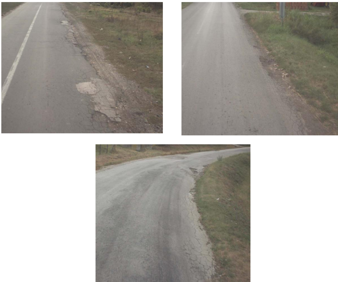
Figura 16 - Rupturi de margine
