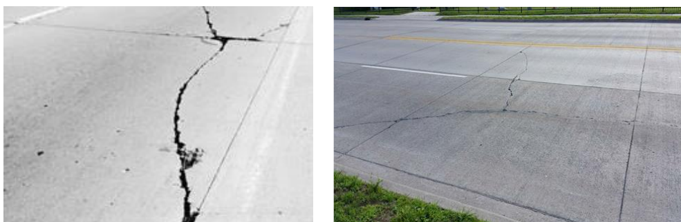
Figura 60 – Fisuri și crăpături diagonale
