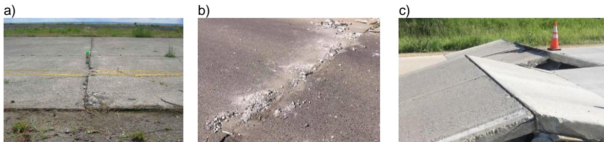
a) – nivel de severitate scăzut (S); b) – nivel de severitate mediu (M); c) – nivel de severitate ridicat (R)
