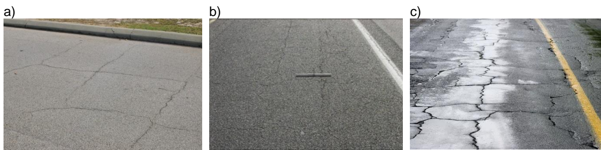
a) - nivel scăzut de severitate (S); b) - nivel mediu de severitate (M); c) - nivel ridicat de severitate (R)
