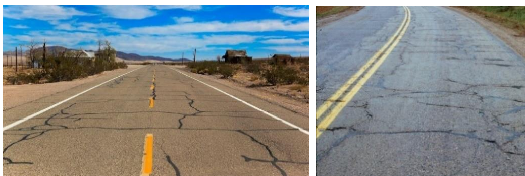
Рисунок 31 - Множественные трещины в разных направлениях
