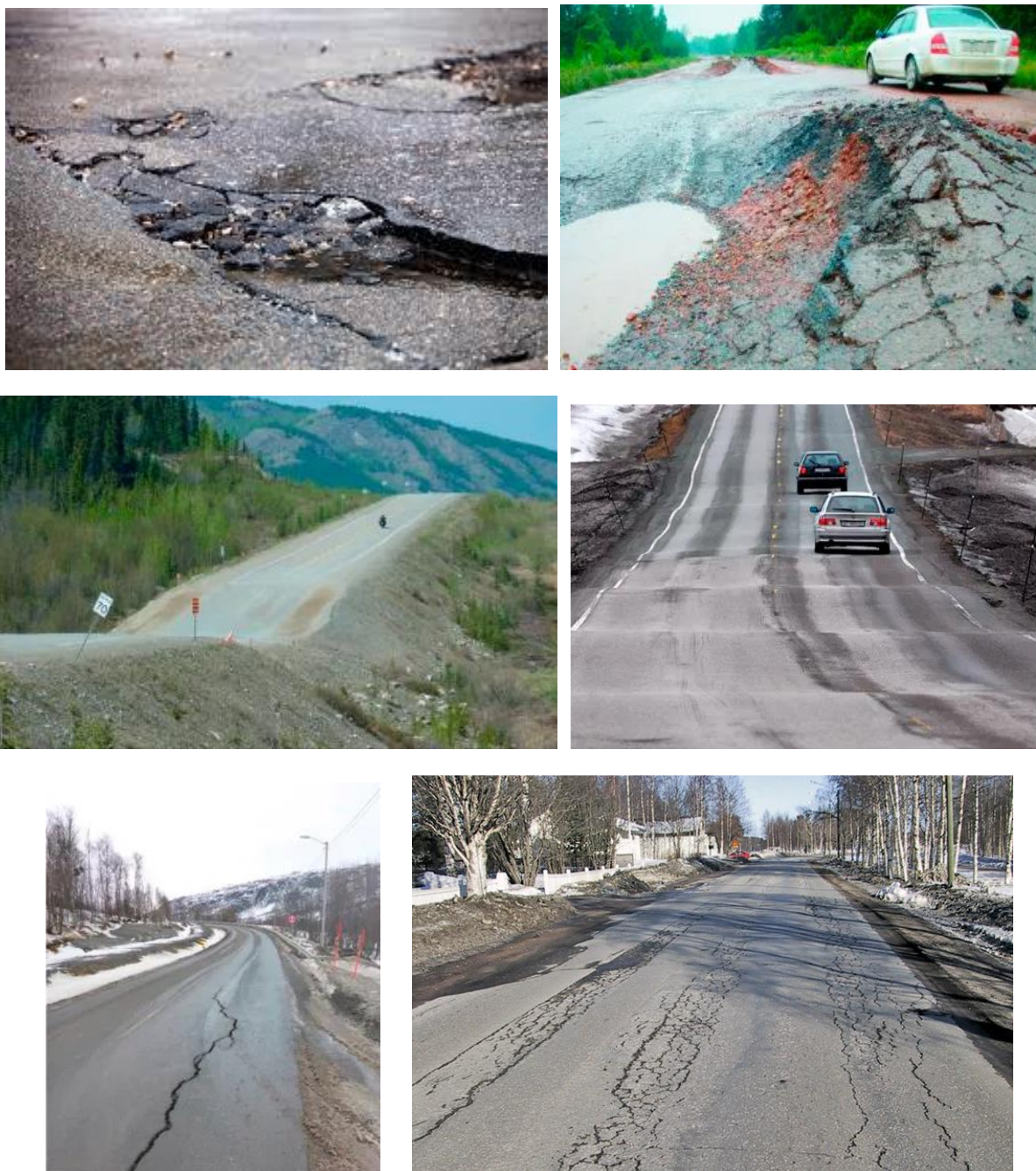
Figura 36 – Degradări provocate de îngheț-dezghet
