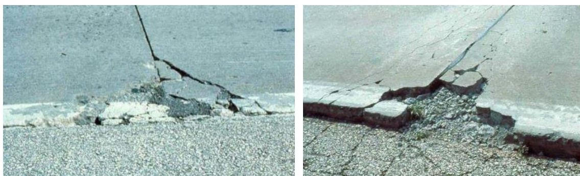
Рисунок 54– Сколы углов плит
