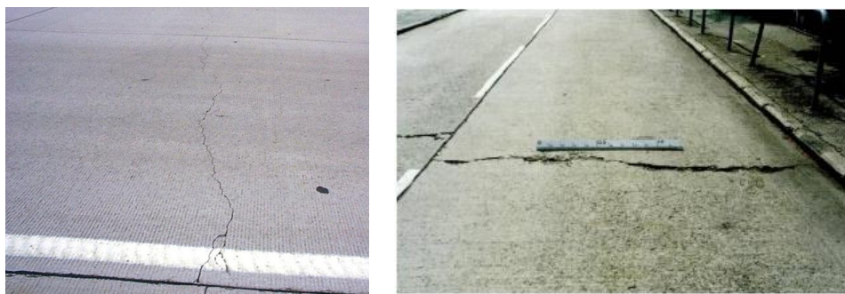
Figura 56 - Fisuri și crăpături transversale
