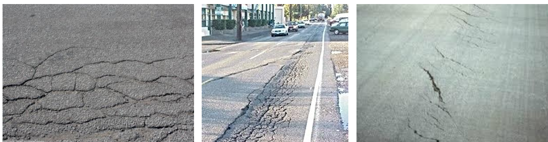
Figura 32 - Fisuri și crăpături unidirecționale multiple
