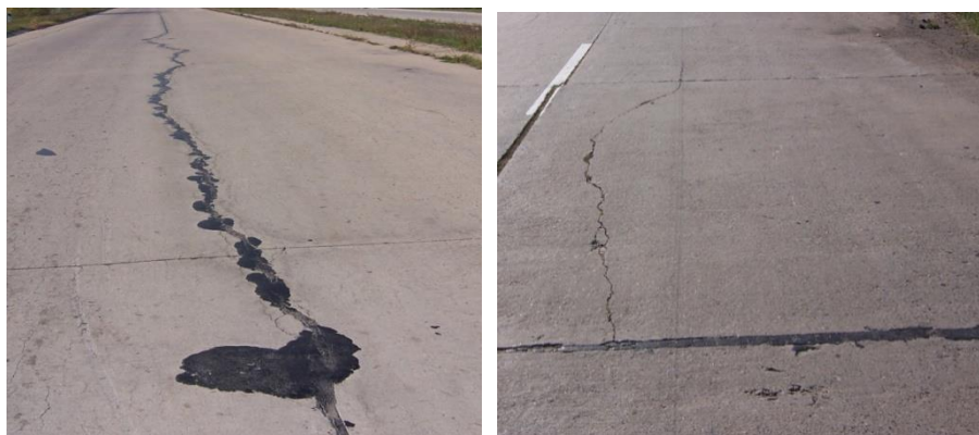
Figura 51 - Rosturi cu mastic în exces
