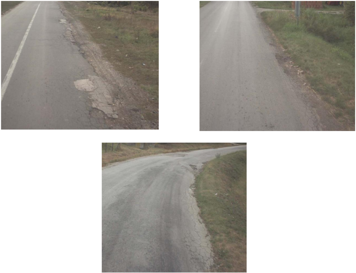
Рисунок 16 – Разрушение (скол) кромок
