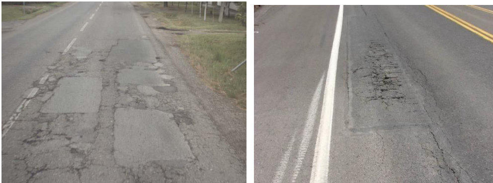
Figura 25 - Plombări cu nivel de severitate ridicat
