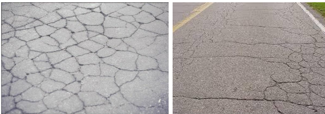
Рисунок 33 - Сетка трещин в виде кожи крокодила
