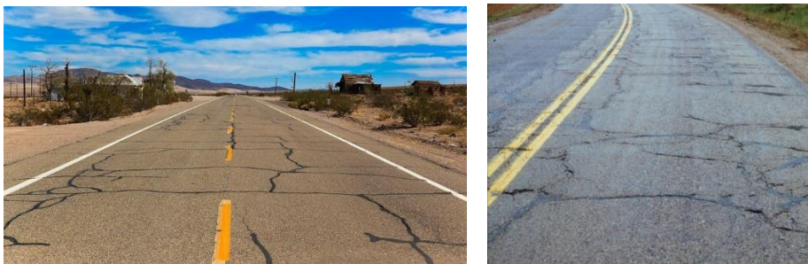
Figura 31 - Fisuri și crăpături multiple pe direcții diferite
