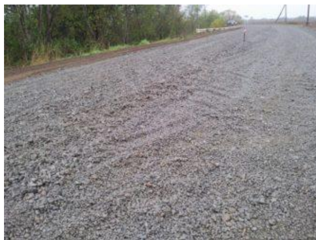
Рисунок 79 – Деформация поперечного профиля дороги
