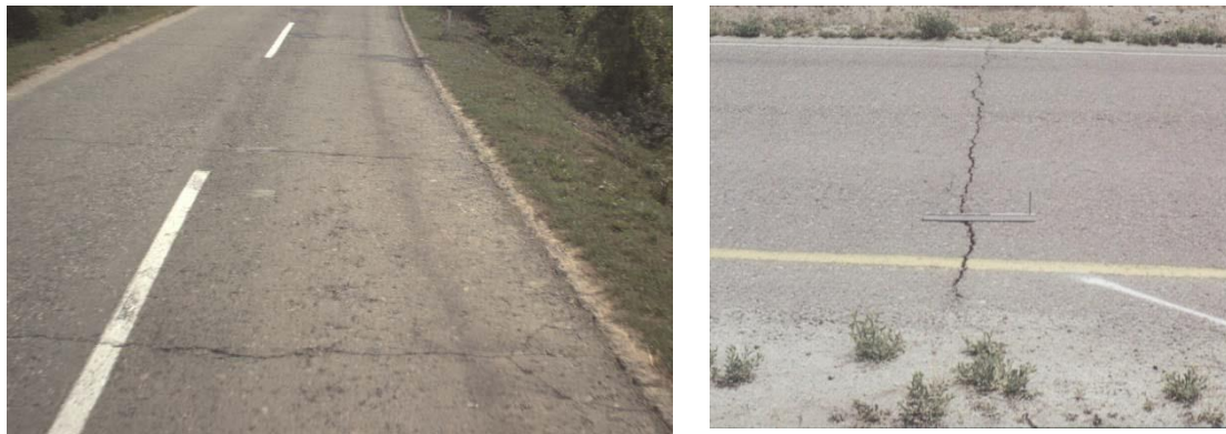
Figura 27 - Fisuri și crăpături transversale
