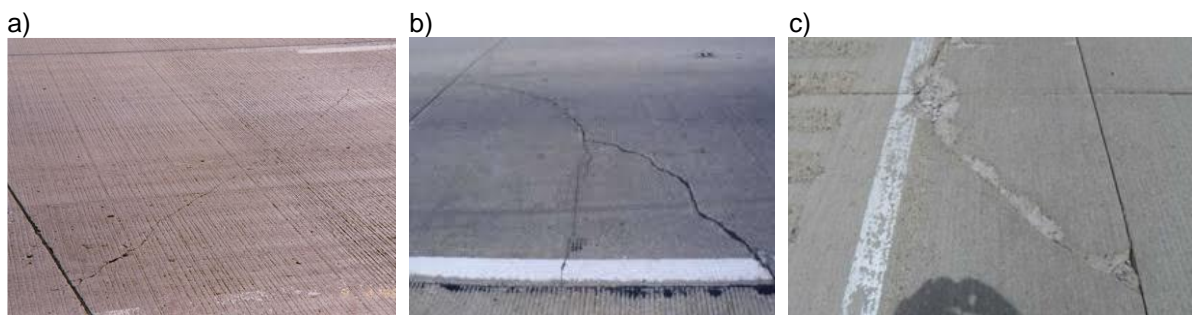
a) – nivel de severitate scăzut (S); b) – nivel de severitate mediu (M); c) – nivel de severitate ridicat (R)
