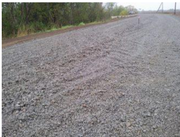
Figura 79 – Deformarea profilului transversal al drumului
