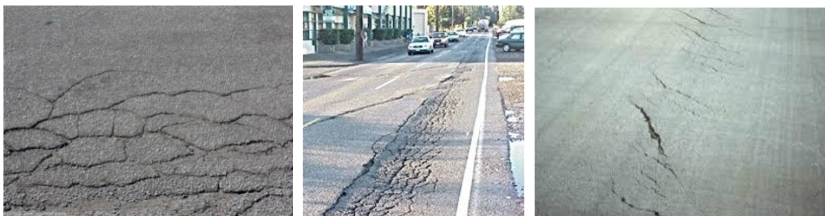
Рисунок 32 - Множественные однонаправленные трещины
