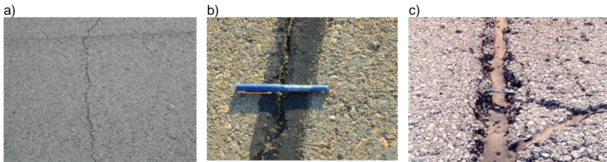
a) - nivel scăzut de severitate (S); b) - nivel mediu de severitate (M); c) - nivel ridicat de severitate (R)
