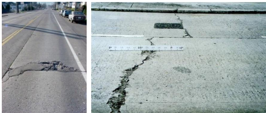
Рисунок 52 - Сколы кромок плит в зоне швов
