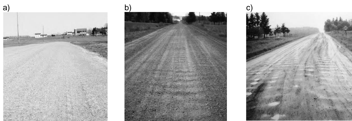
a) – nivel de severitate scăzut (S); b) – nivel de severitate mediu (M); c) – nivel de severitate ridicat (R)
