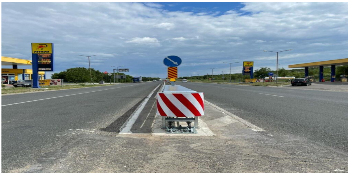
Figura 11 - Atenuatoare de șoc la începutul zonelor centrale
