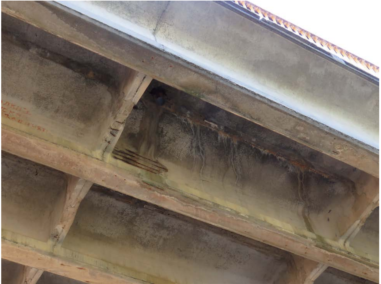
Figura 14. Suprastructura. Degradarea betonului infiltrații ape pluviale, expunerea, corodarea armaturii, exfolierea stratului de protecție a armaturilor la grinzi, prezența, eflorescențe, pete de săruri
