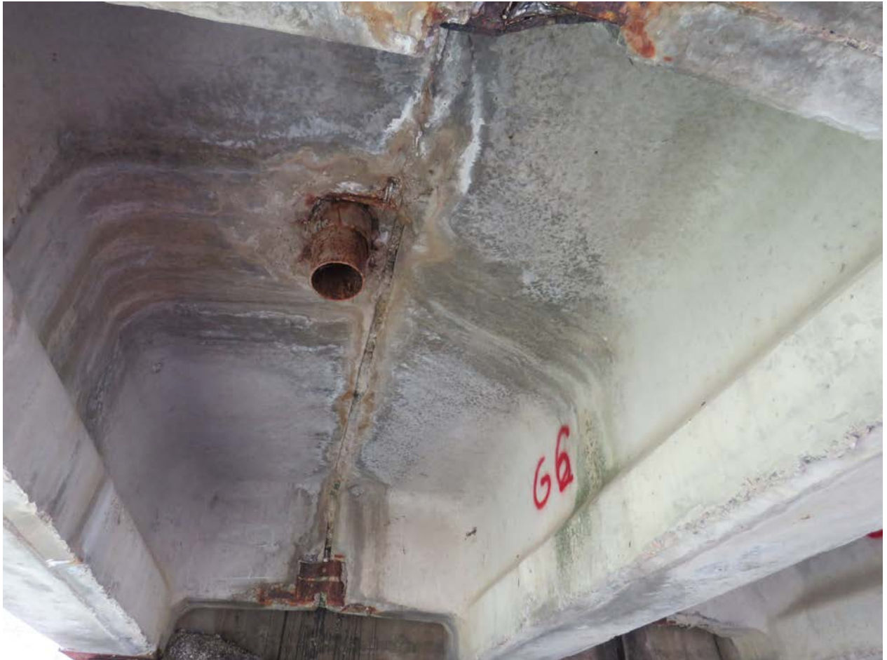
Figura 8.Vedere Culee nr.1. Infiltrații prin guri de scurgere, degradarea avansată a zidului de gardă. Eflorescențe.
