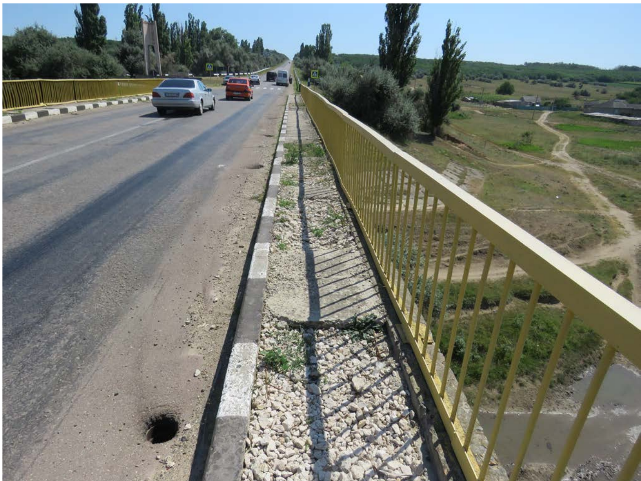
Figura 5, 5.1. Zona trotuarului pe dreapta podului. Blocuri de trotuar din beton degradate avansat, lipsa grilajelor gurilor de scurgere
