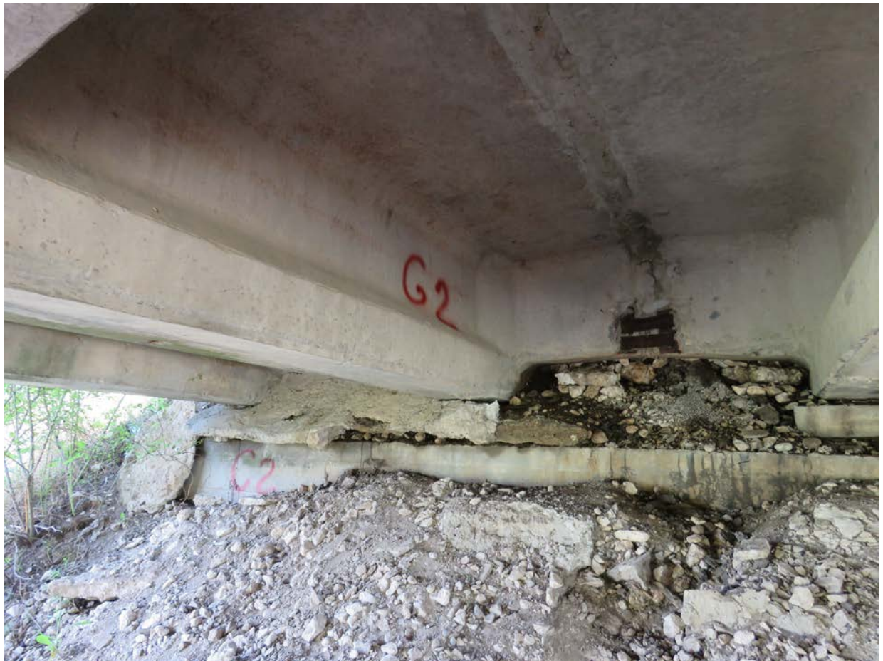
Figura 9. Culeea Nr.2. Degradarea zidului de gardă la culeea nr. 2.
