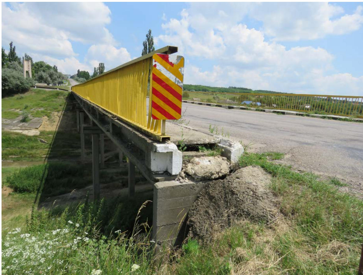
Figura 6. Vedere acces, racordarea podului cu rampe de acces, lipsa parapetului de siguranță pe pod/la accese, marcaj vertical montat neconform.
