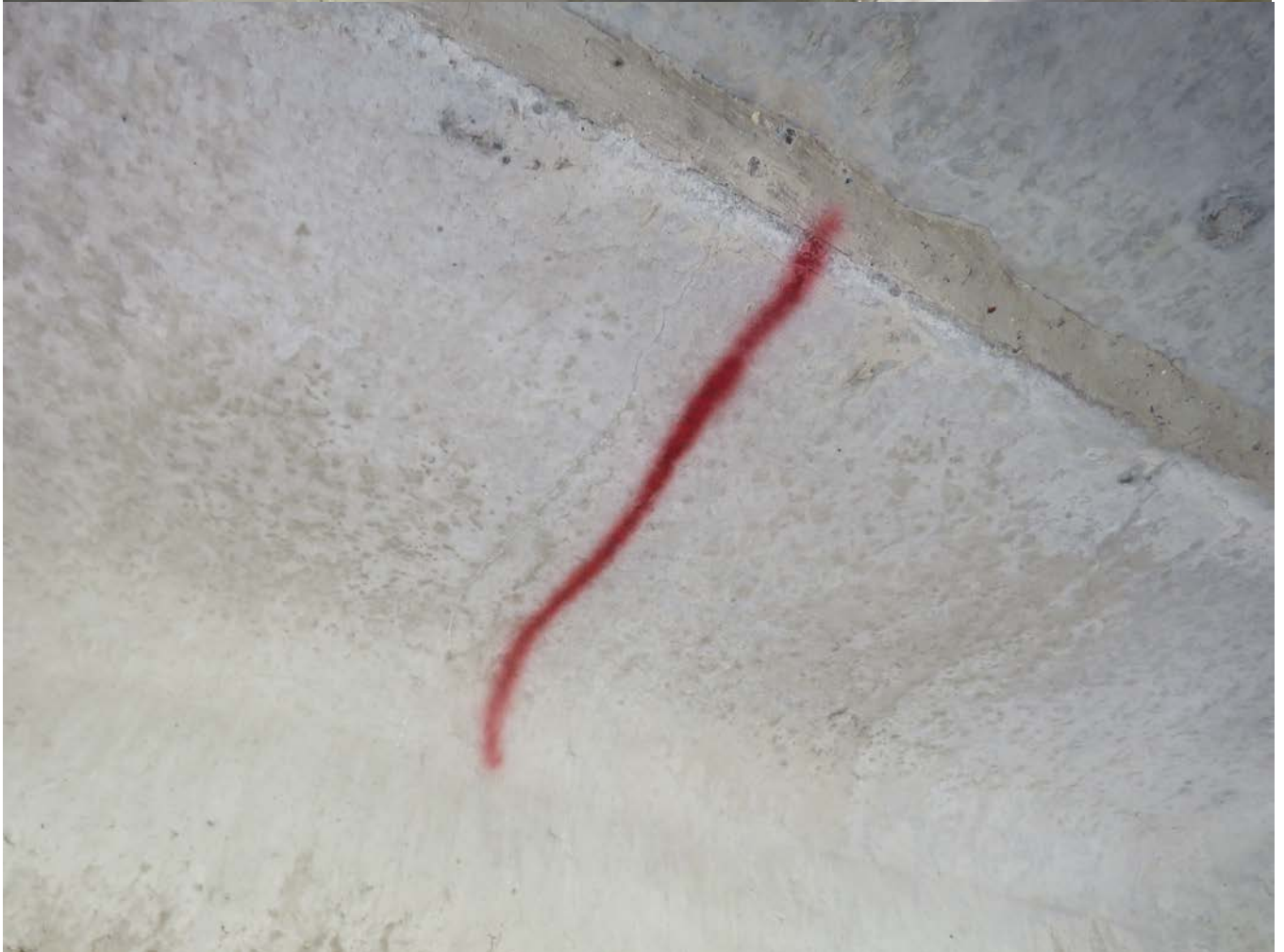
Figura 13, 13.1. Fisuri cu infiltratii la intradosul grinzilor, stalactite, eflorescențe, pete de săruri
