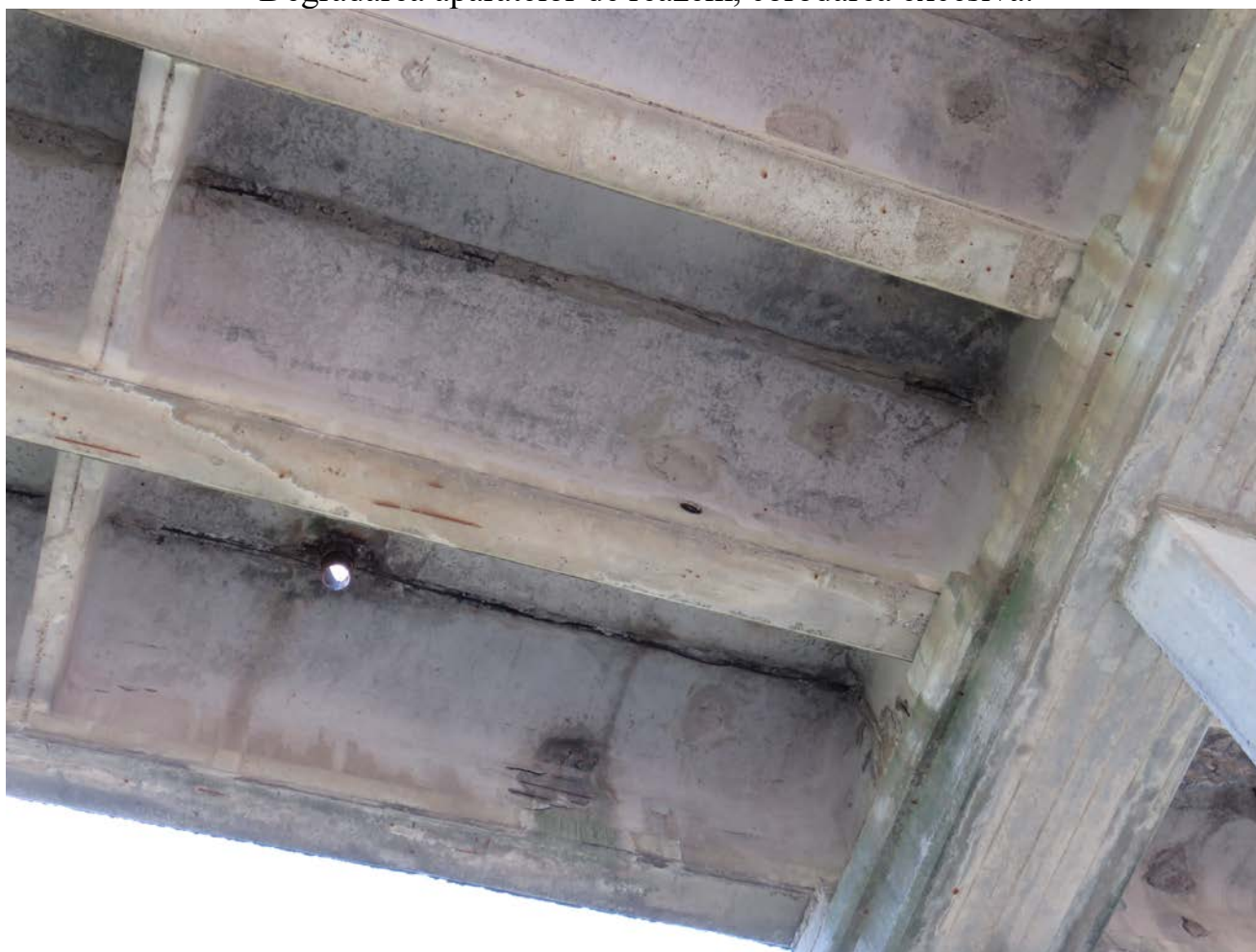
Figura 12. Vedere pila Nr.2. Desprinderi de beton cu armături expuse, infiltrații la nivelul riglei, infiltrații la intradosul grinzilor, lipsa dispozitivelor antiseismice
