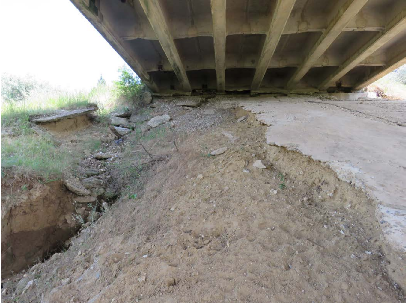
Figura 10, 10.1. Eroziunea sfertului de con. Cumulări de pământ pe rigla culeii.
