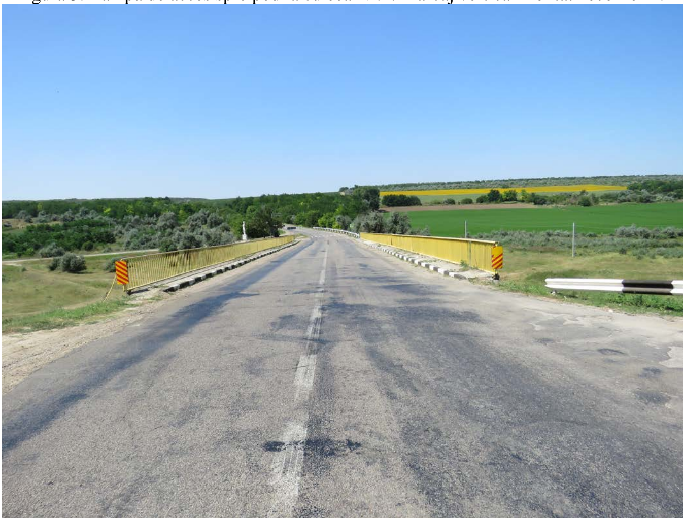
Figura 4. Vedere cale pod culeea Nr.4. Lipsa parapetului direcțional
