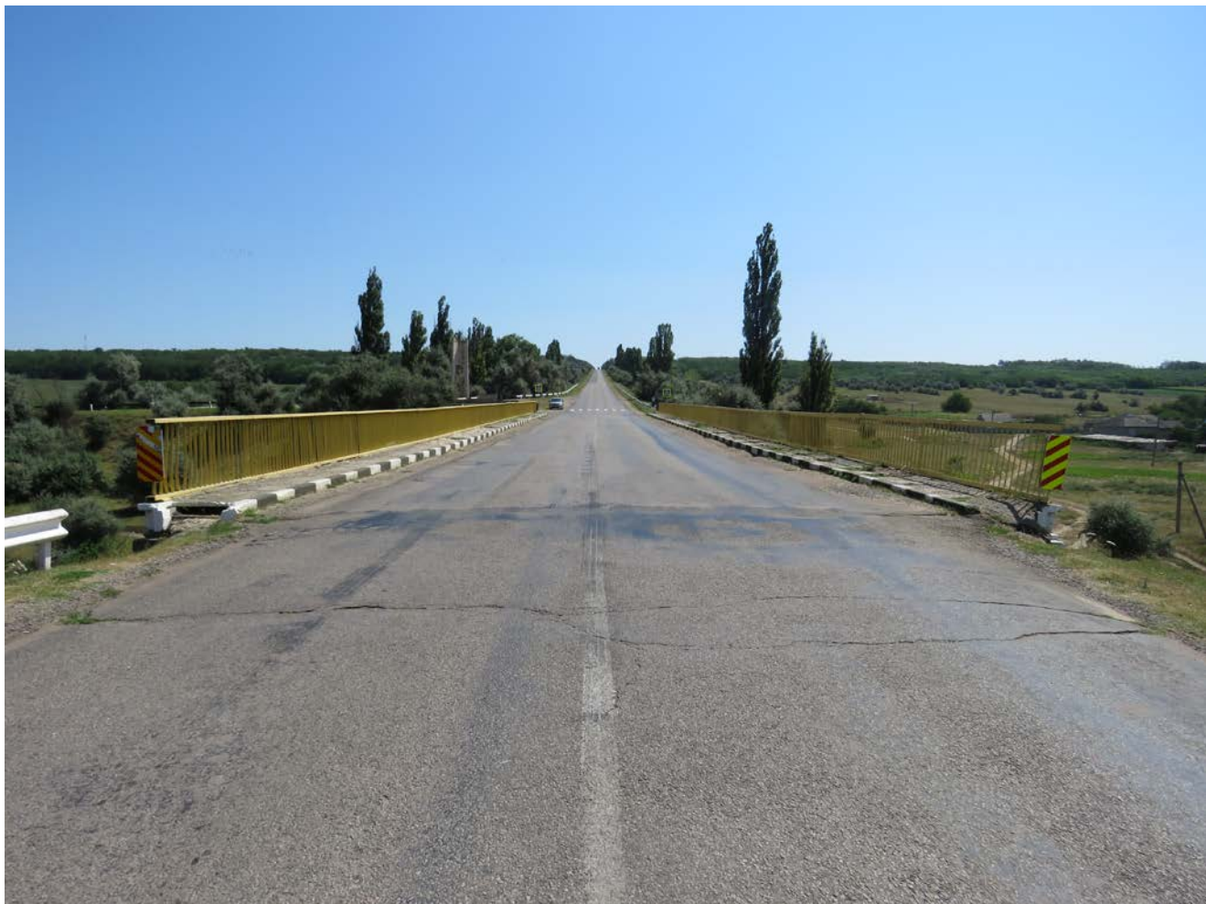
Figura 3. Rampa de acces spre pod la culeea Nr.1. Marcaj vertical montat neconform.
